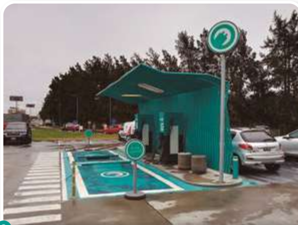
Estación de carga de autos eléctricos que funcionan mediante baterías de litio, en la Autopista Buenos Aires-La Plata, Argentina.
